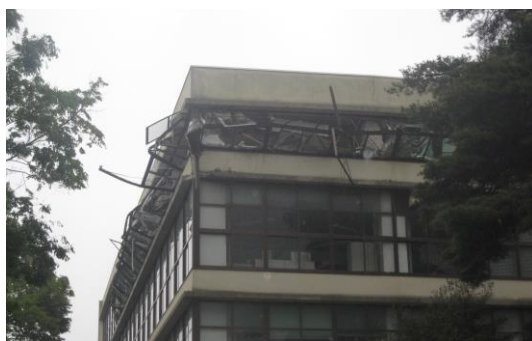
4階の執務室が倒壊(私は不在、負傷者無し) 東日本大震災:平成 23 年 3 月 11 日
